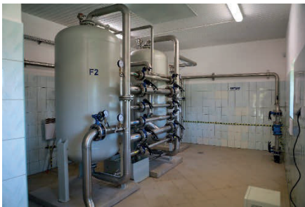
Stacja Uzdatniania Wody.
